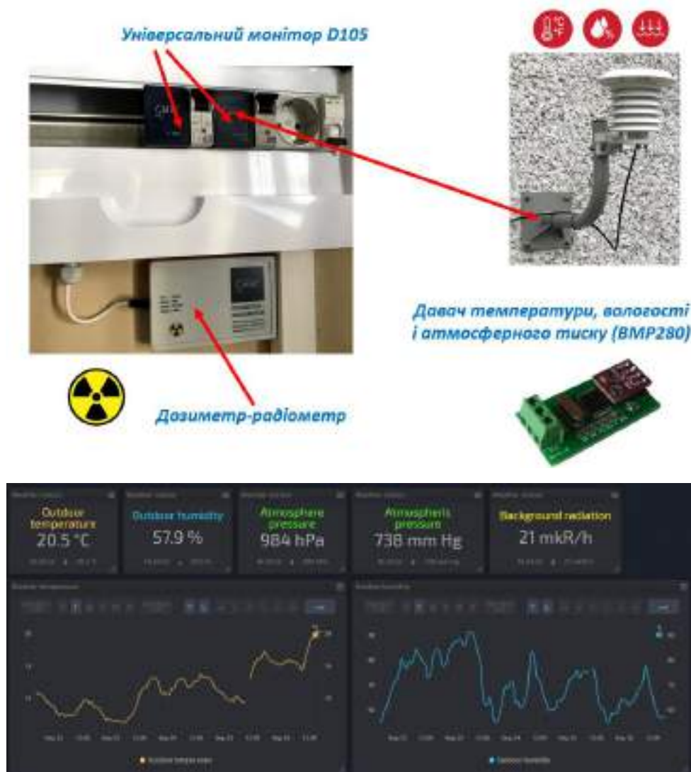
Рисунок 8 – Реалізація частини метеорологічного модуля системи енергетичного моніторингу будівлі, що призначений для реєстрації температури та вологості зовнішнього повітря і значення атмосферного тиску
